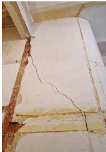
Fotografia de les patologies.
