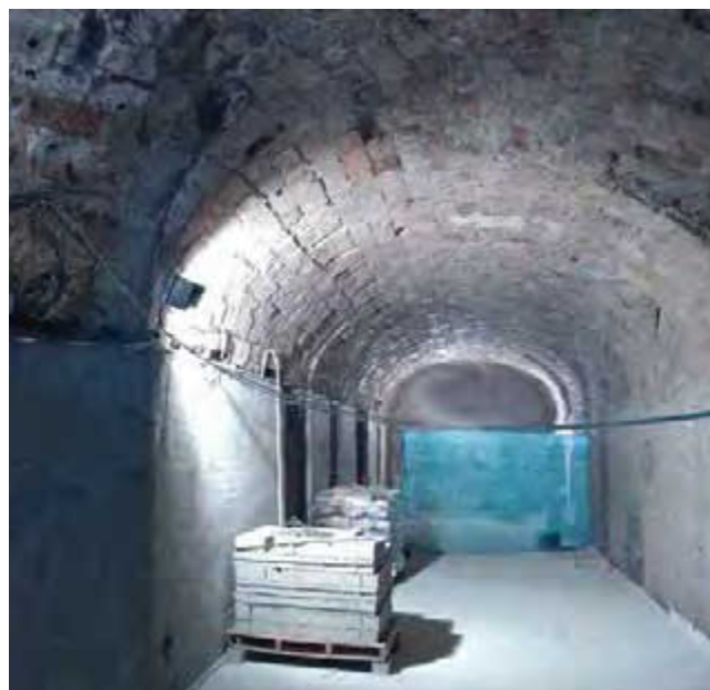
Figura 15. Planta sótano una vez concluida la reforma estructural. Se puede observar el encamisado de hormigón del muro central.
