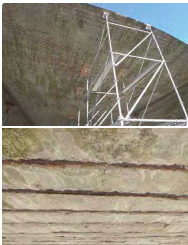
Figura 18. La exagerada corrosión de la armadura de algunas zonas forzó a apuntalar las láminas.
