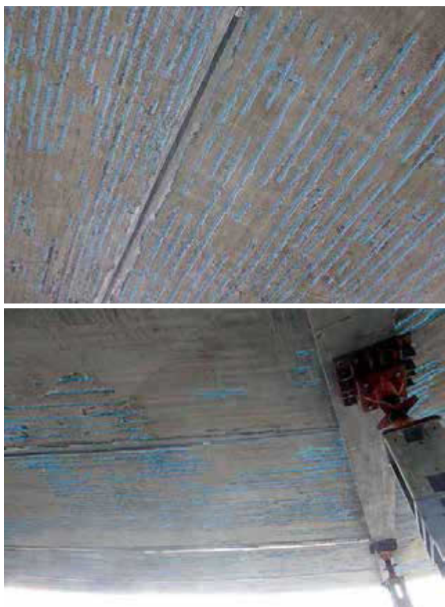
Figura 19. La gran cantidad de barras afectadas por la corrosión nos llevó a adherir fibras de carbono en la cara inferior de las láminas.
