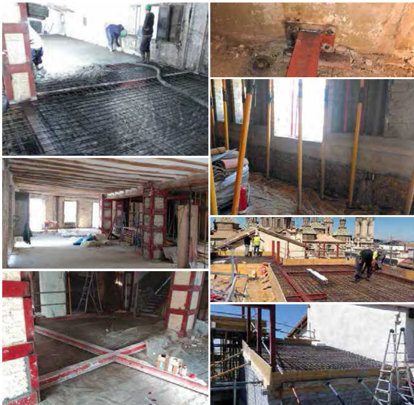
Figura 17. Diferentes intervenciones en la obra: realización de losas de forjado sobre el forjado existente, que hacen la función de encofrado, y después, en la obra finalizada, tienen función estética.
