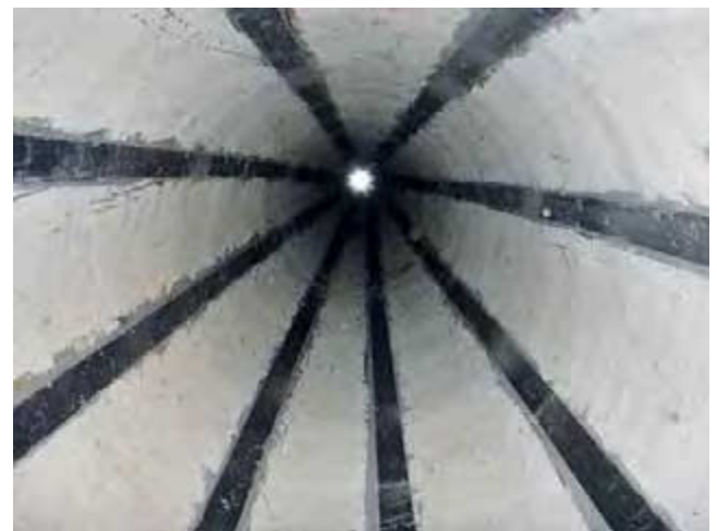
Figura 18. Refuerzos de Carboplate E170.
