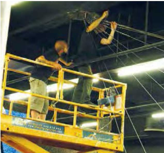
Figura 4. Proceso de ajuste de los cables en obra por los técnicos de GROF.
