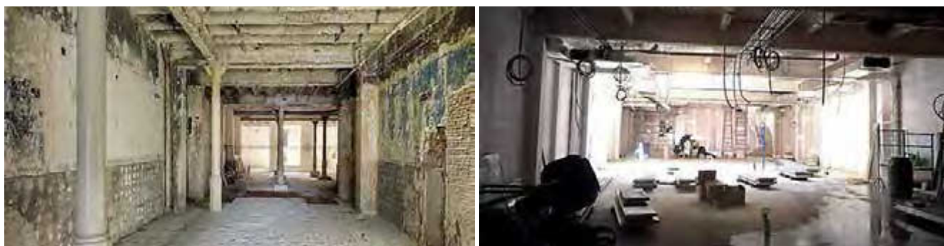
Figura 2. Creació d'un espai diàfan i lliure de impediments a tota la planta baixa, des del Passeig de Gràcia fins al fons de la parcel·la, amb la supressió dels pilars de fosa i de parets de càrrega, i la seva substitució per jàsseres recolzades sobre nous pilars.
