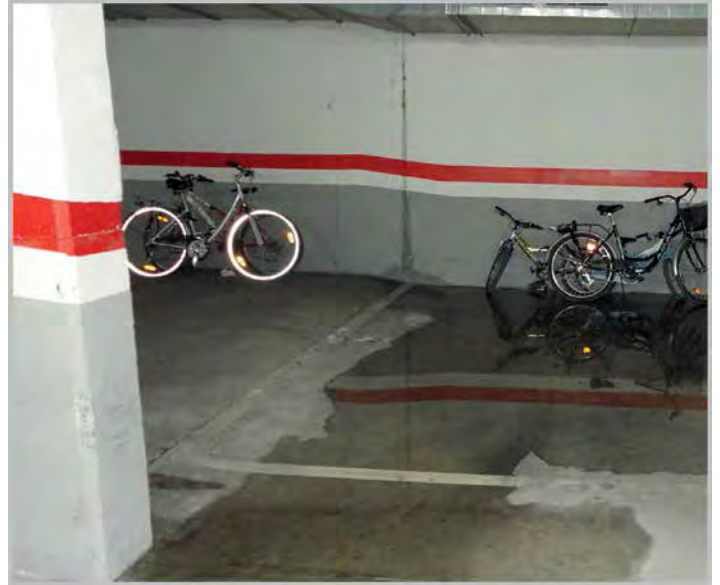
» FILTRACIONS D'AIGUA EN SOTERRANIS
