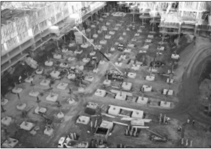
Fig. 9. Movimiento de tierras en solera y encepados y pilares del aparcamiento P5, en Zona central.
