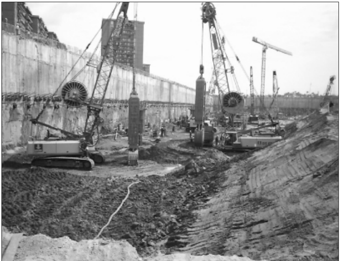
Fig. 6. Ejecución de los pilotes panel. Se pueden ver los anclajes provisionales sobre el muro.
