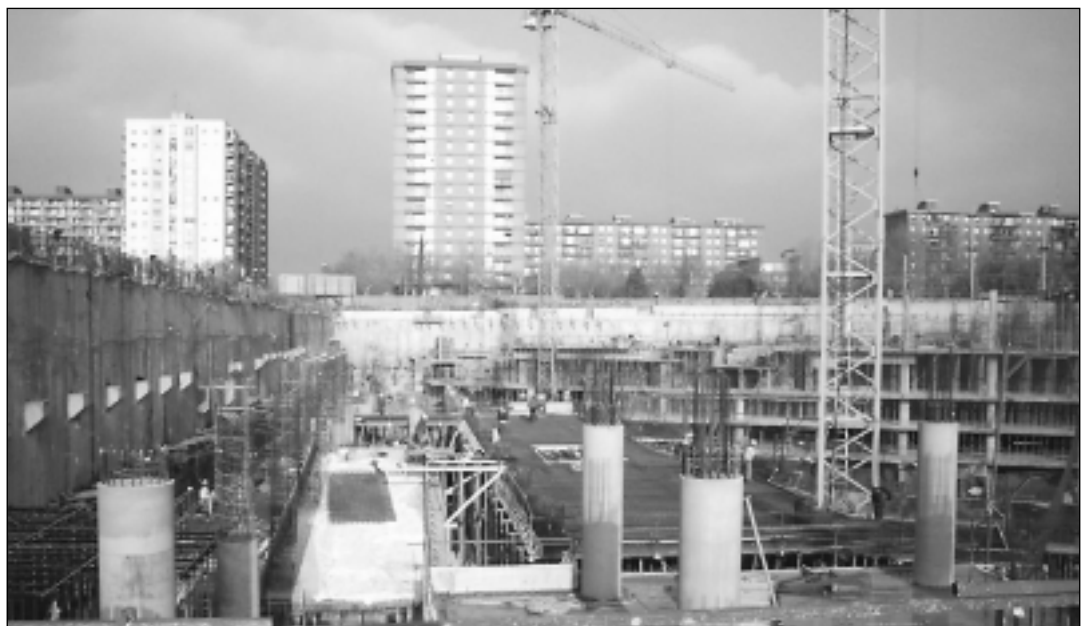
Fig. 4. En el muro se puede ver la alineación de las ménsulas para apoyo del forjado.
