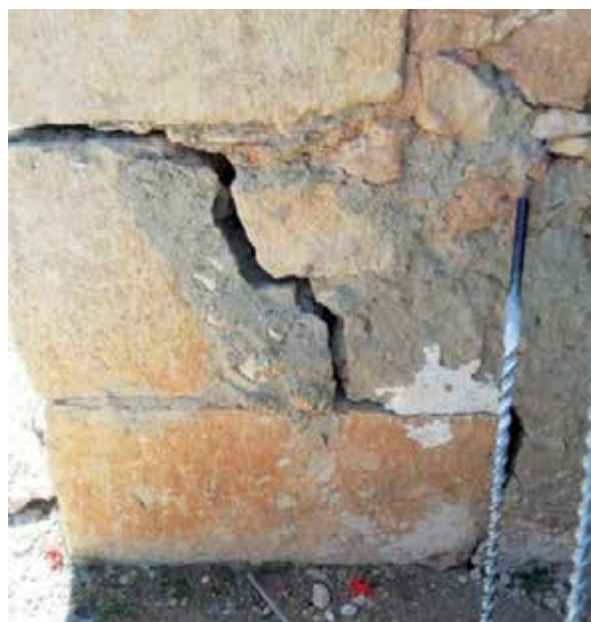
Figura 10. Patología producida por asentamiento diferencial vertical de cimentación.
