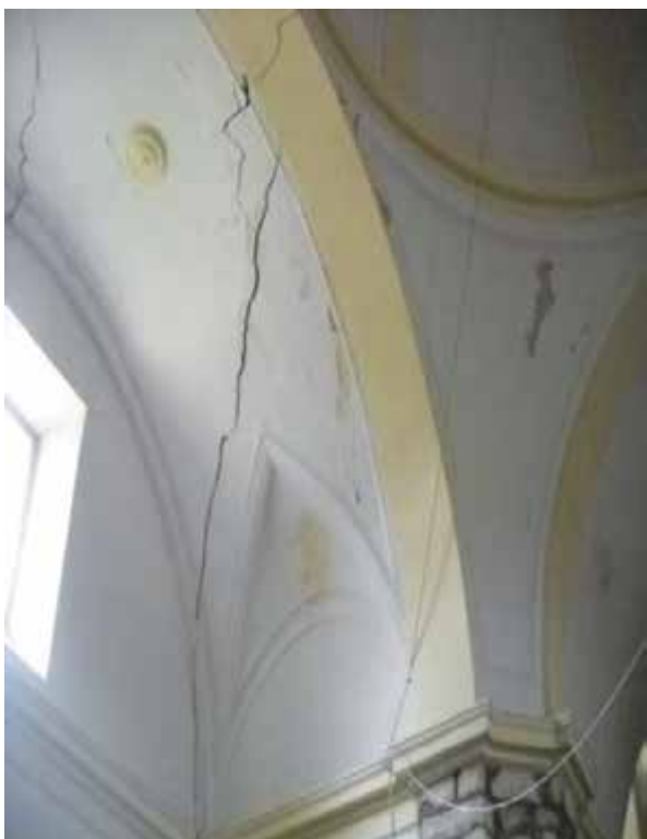
Figura 9. Patología en los paramentos interiores.
