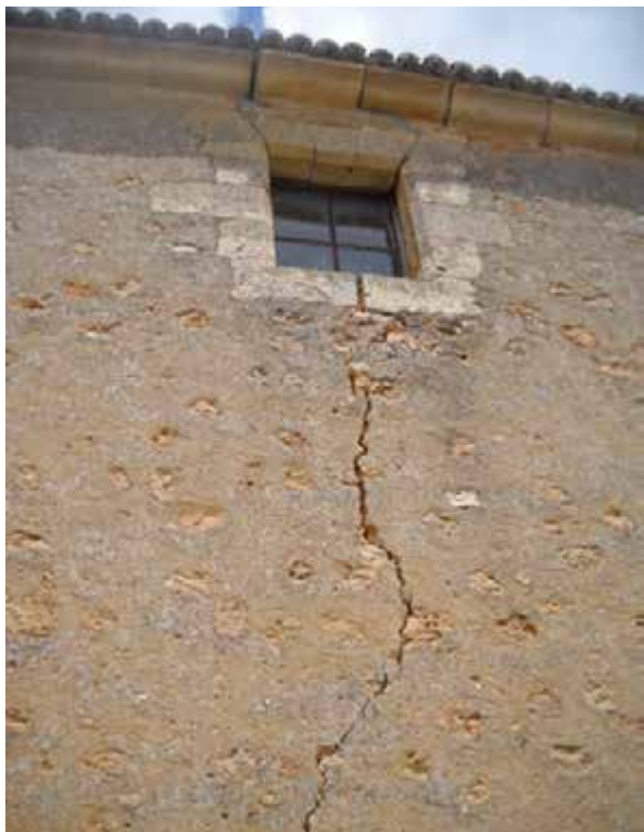
Figura 8. Patología en los paramentos exteriores.
